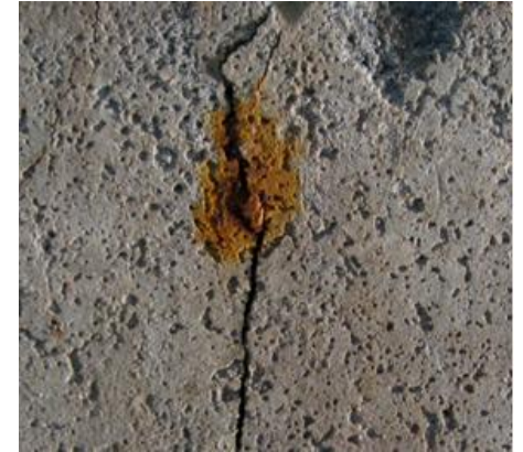
Béton corrodé et craquelé
